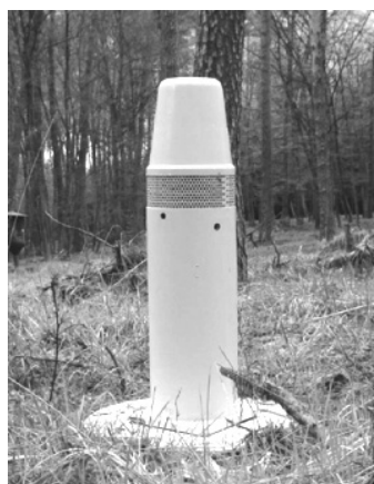
Rys. 2. Urządzenie (wieża) UOZ-1 na magistrali E-20 Mińsk Mazowiecki-Siedlce UOZ-1 [3, 14]
