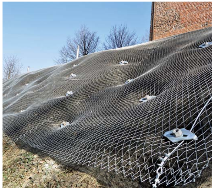
Skarpa zabezpieczona siatką systemu Tecco
