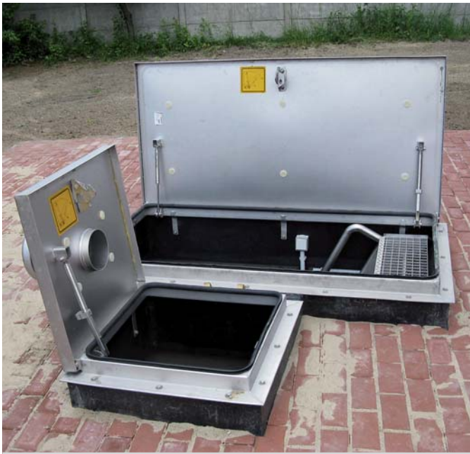
Właz nad zejściem do tłoczni po schodach i właz nad pompą
