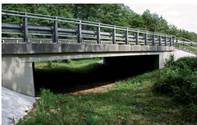
Przejście dla małych zwierząt w formie mostu (DK74), fot. R. Kurek
