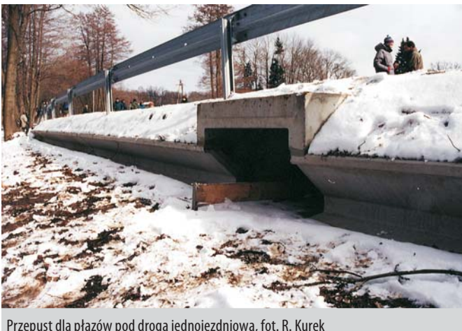
Przepust dla płazów pod drogą jednojezdniową, fot. R. Kurek
