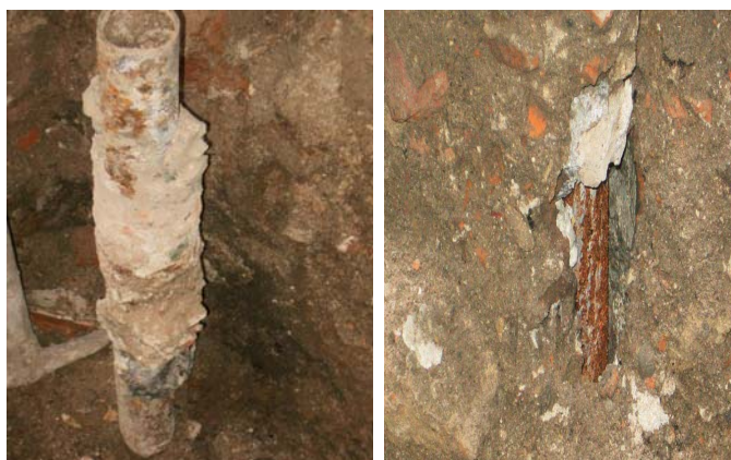
Ryc. 1. Przykłady odkopanych mikropali zbrojonych rurami stalowymi
