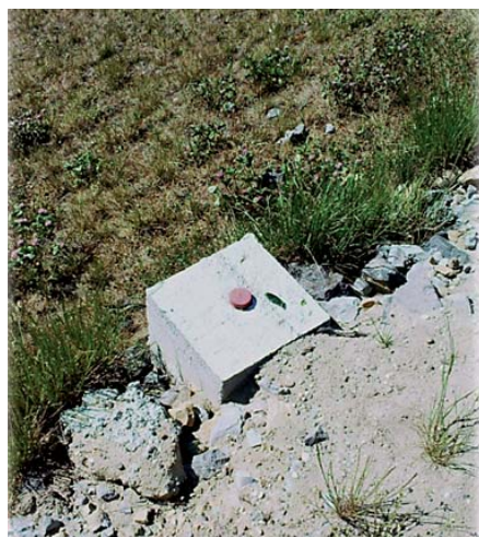
Ryc. 2. Głowica reperu ziemnego; punkt geodezyjnej obserwacji przemieszczeń pionowych
