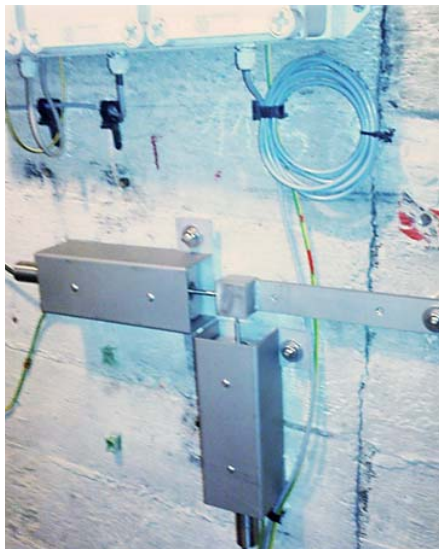
Automatyczny, zdalczyny szczelinomierz wskazujący przemieszczenia sekcji oddzielonych dylatacją
