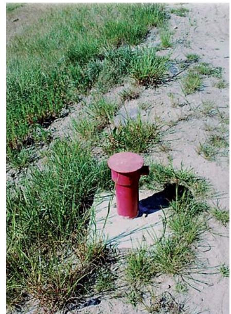
Górna część typowego piezometru otwartego; pomiar położenia zwierciadła wody w piezometrze służy kontroli filtracji przez budowlę piętrzącą lub w podłożu
