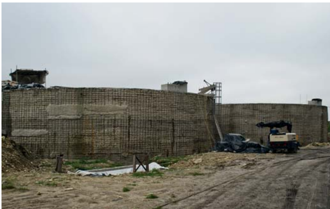
Ściany zewnętrzne po skuciu otuliny zewnętrznej. Przygotowanie ścian do natrysku, fot. archiwum MPWiK Sp. z o. o. w Jaworznie
