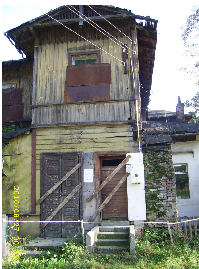
Fot. 3. i 4. Przykłady zdewastowanych drewniaków, stan tzw. „śmierci technicznej obiektu
