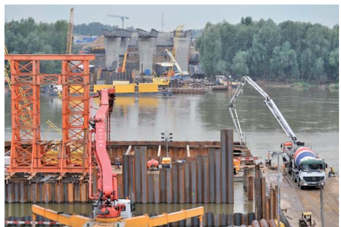
Widok na lewobrzeżną część budowy mostu, fot. S. Klorek, wł. archiwum CEMEX Polska
