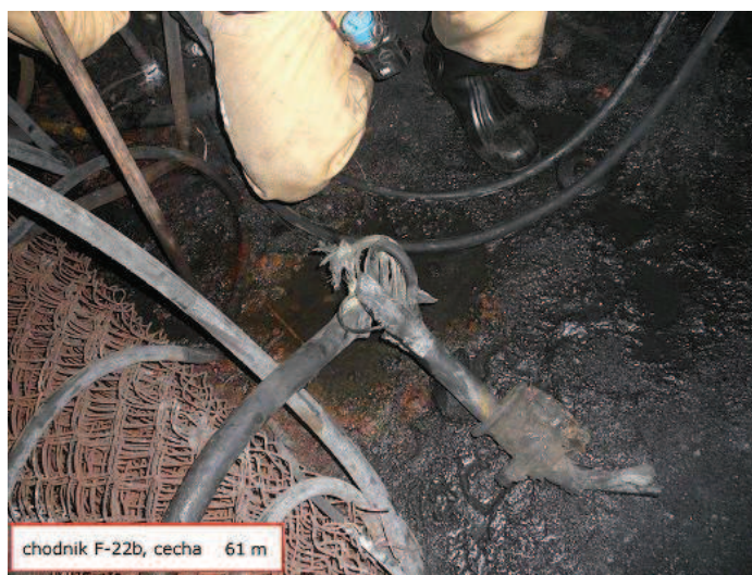
Fot. 1. Uszkodzony przewód [wg 5]
