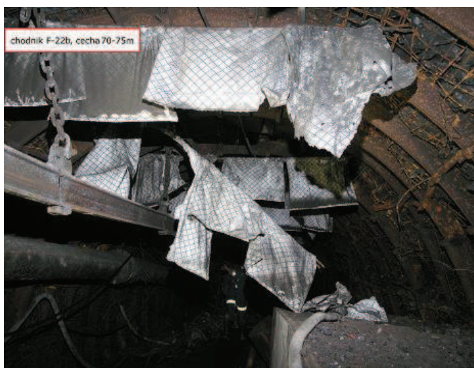
Fot. 2. Uszkodzenie zapory wodnej [wg 5]
