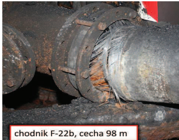
Fot. 3. Rozszczelnienie rurociągu [wg 5]
