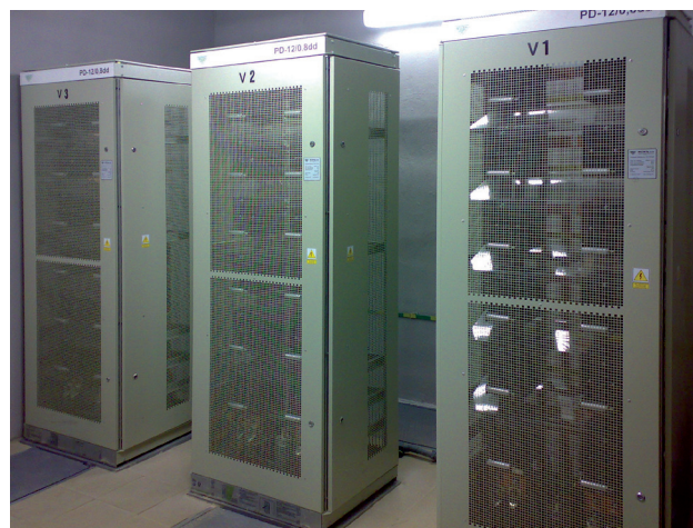
Fot. 3. Nowe zespoły prostownikowe – stacja „Zgierska”
