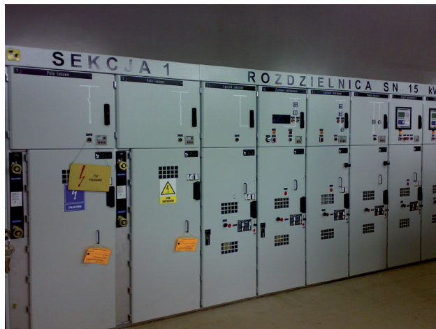
Fot. 2. Nowa rozdzielnica 15 kV (RSN) – stacja „Zgierska”
