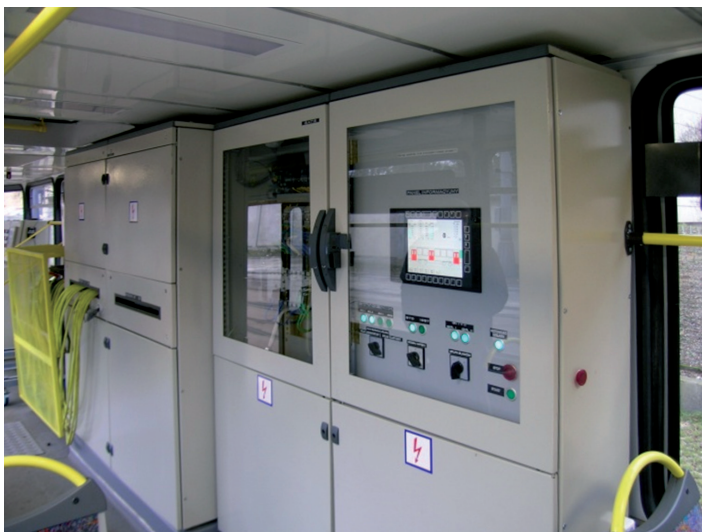
Fot. 2. Stanowisko do badania przekształtników
