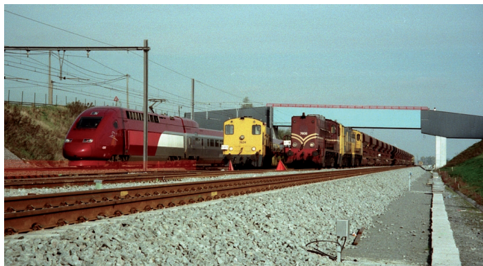
Fot. 4. Budowa linii dużych prędkości HSL 1 – kiedy na nowej linii układano jeszcze tory i wysypywano tuczeń, to już na liniach konwencjonalnych trwały jazdy testowe pociągów TGV (22.10.1996 r.) Fot. I. van Steevinkel
