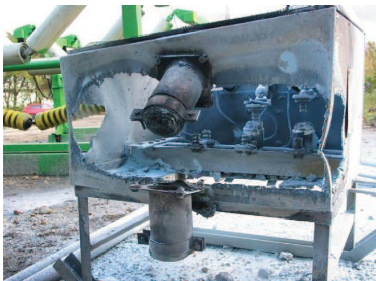
Fot. 5. Skutki zwarcia powstałego w wyniku wrzucenia klucza do szafki kablowej 6 kV – miejsce wypadku ciężkiego
