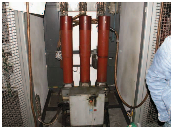
Fot. 4. Miejsce wypadku ciężkiego przy zakładaniu uziemiacza bez uprzedniego sprawdzenia obecności napięcia – niewłaściwa organizacja pracy
