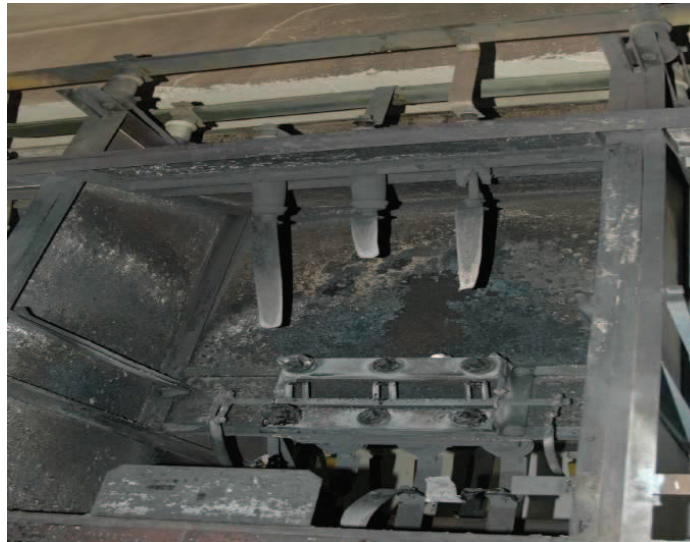
Fot. 2. Pole rozdzielni 6 kV po zaistnieniu zwarcia – miejsce wypadku śmiertelnego podczas pracy bez polecenia w pobliżu napięcia
