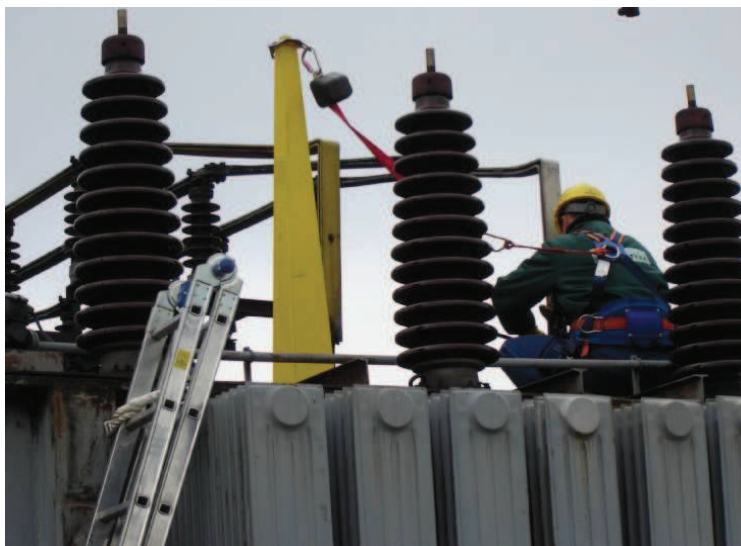
Fot. 1. Zastosowanie słupa asekuracyjnego jako przykład środka zabezpieczającego pracownika przed upadkiem z wysokości
