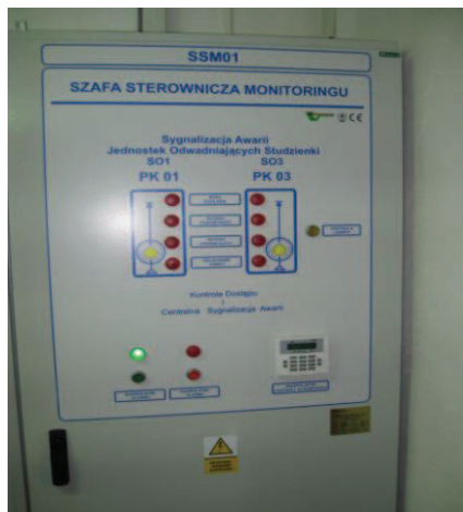
Rys. 2. Widok szafy sterowniczo-sygnalizacyjnej
