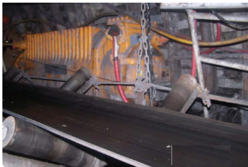
Rys. 2. Widok stacji transformatorowej zmodernizowanej przez MARTECHPLUS
