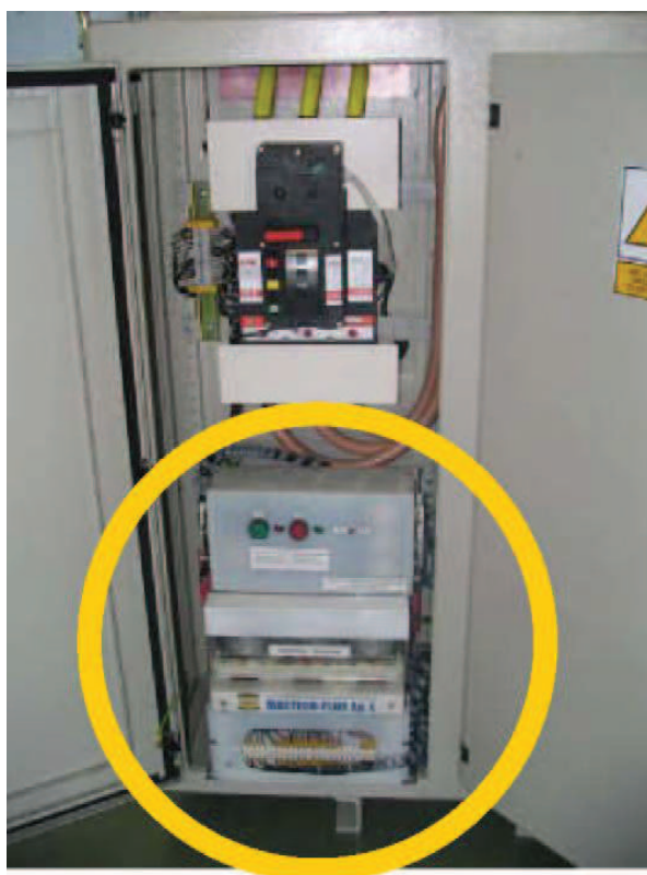
Rys. 7. Stacja MARTB - Komora wyłącznika mocy DN – wyłącznik próżniowy WP 630
