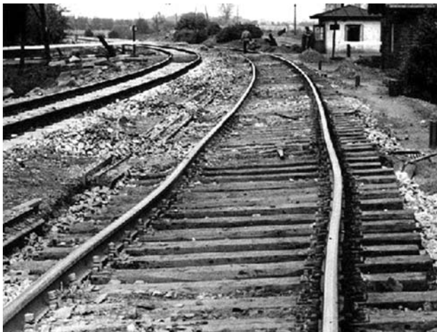
Rys. 2. Odkształcenie toru poprzedzające wyboczenie – skutek złego utrzymania toru
