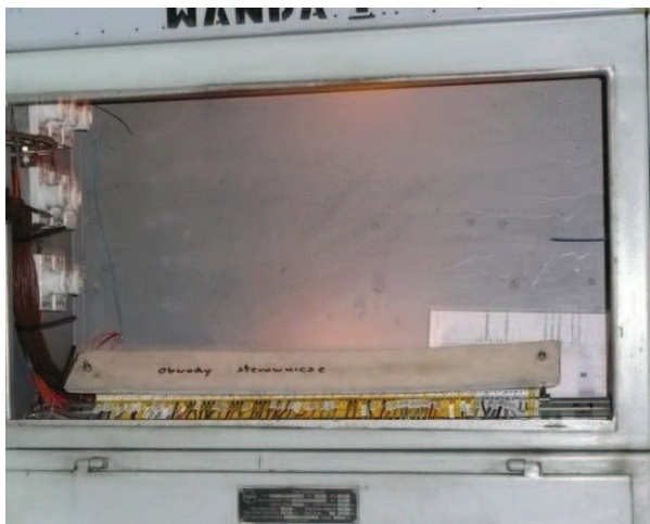
Rys. 4. Widok wnętrza celki n/n rozdzielnic RSW zmodernizowanej metodą klasyczną
