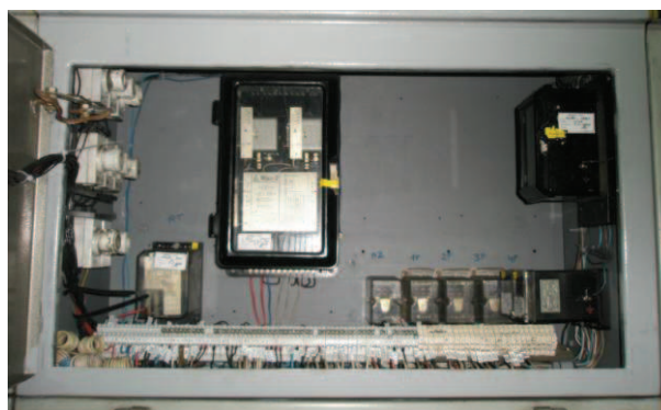
Rys 2. Widok wnętrza celki n/n rozdzielnic RSW przed modernizacją
