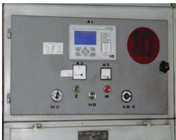
Rys 3. Widok drzwi celki n/n rozdzielnic RSW zmodernizowanej metodą klasyczną
