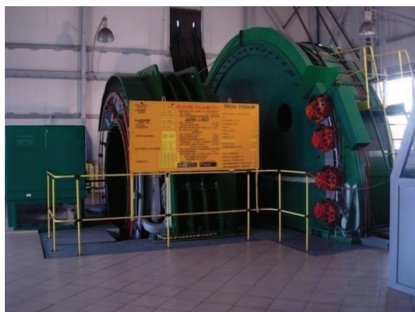
Rys. 1. Widok napędu modernizowanej maszyny wyciągowej
