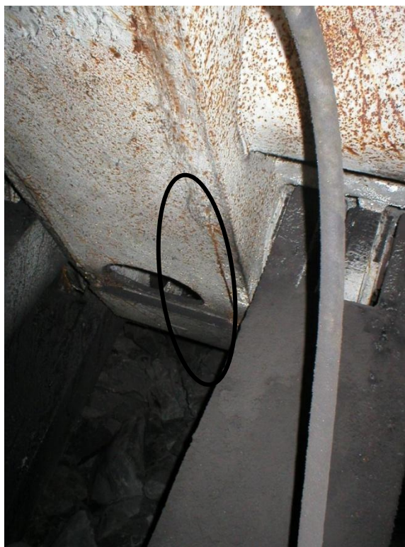
Rys. 2. Przykład pęknięcia spoiny łączącej poszycie dolne osłony odzawałowej z tężnikiem Fig. 2. An example of a broken weld connecting the lower plating of the gob shield with the brace
