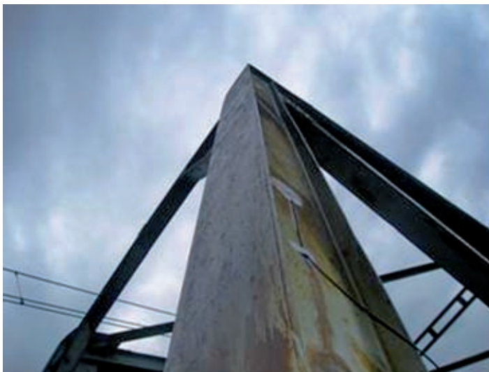
Rys. 6. Czujnik piezoelektryczny z okablowaniem, zamontowany na elemencie nośnym mostu Fot. archiwum IPPT PAN
