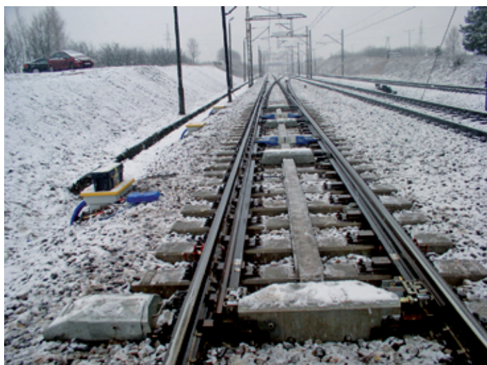
Rys. 6. Rozjazd zwyczajny 60E1-1200-1:18,5 HYDROSTAR, zabudowany na stacji Włoszczowa Północna Centralnej Magistrali Kolejowej
