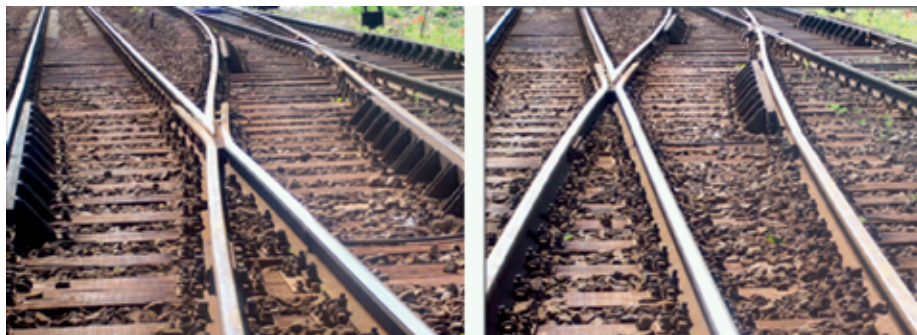
Rys. 6. Niedokładne wytyczenie pojedynczego połączenia torów równoległych, skutkujące skróceniem wstawki prostej do ok. 1,8 m
