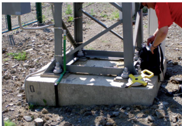
Rys. 9. Uziemienie stupa na terenie podstacji zasilającej Grygov
