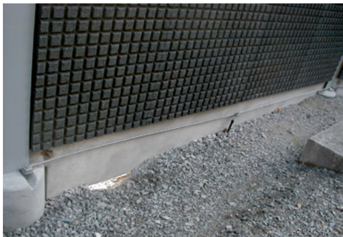
Rys. 18. Połączenie na dole ekranu akustycznego przewodem gołym FeZn
