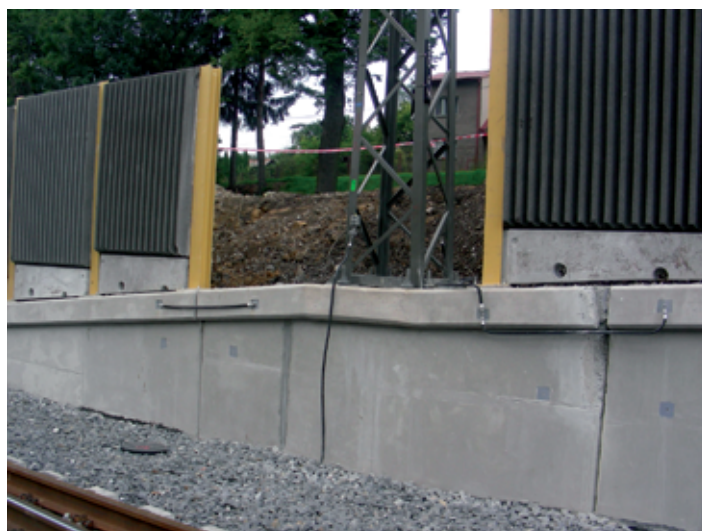
Rys. 16. Uszynienie muru oporowego z ekranem akustycznym przez słup trakcyjny na stacji kolejowej Bystřice
