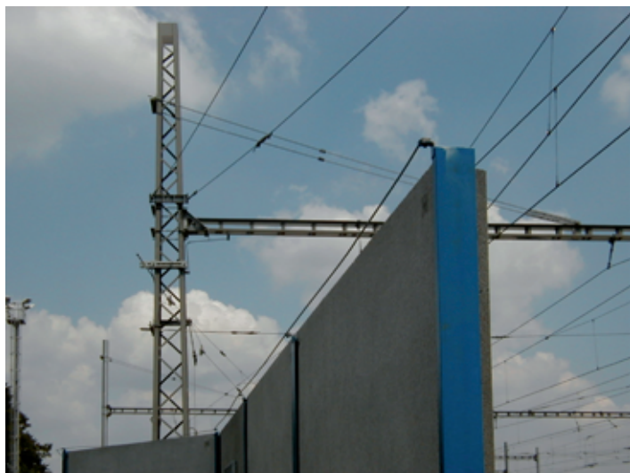
Rys. 19. Połączenie na górze ekranu akustycznego przewodem gołym FeZn
