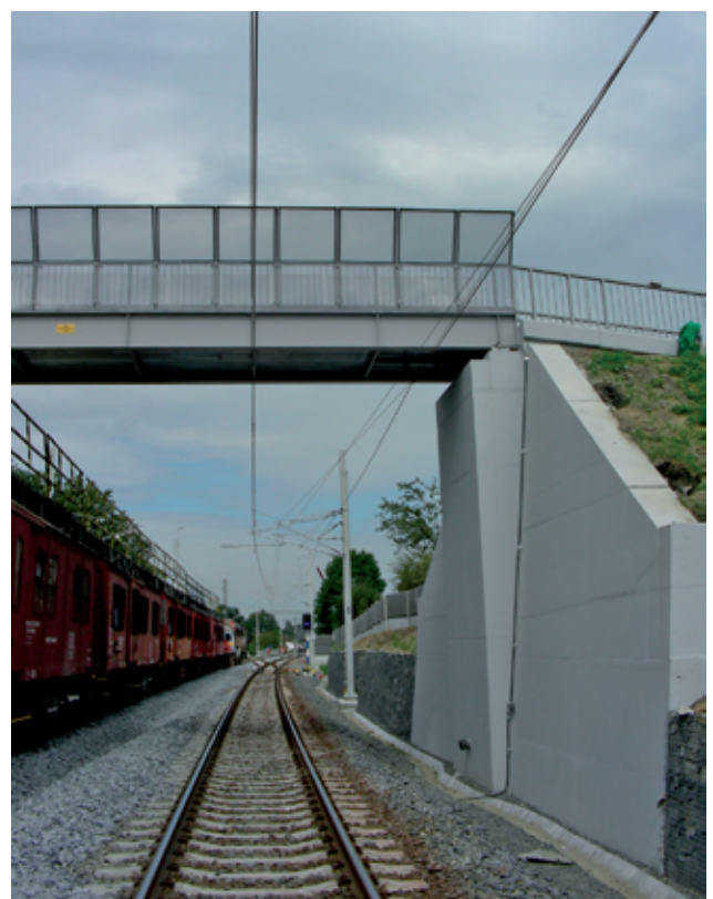
Rys. 10. Uszynienie wiaduktu przez iskiernik na stacji kolejowej Bystrice
