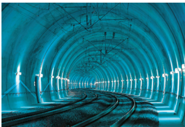
Rys. 12. Wysięgniki sieci trakcyjnej w tunelu
