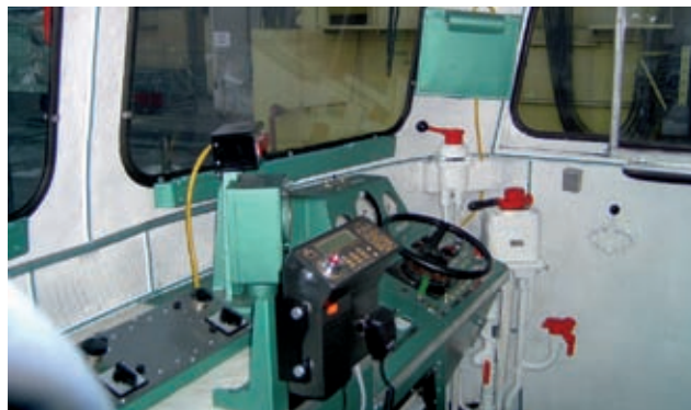
Rys. 12. Manipulator radia w kabinie sterowniczej lokomotywy ST44 (M62)
