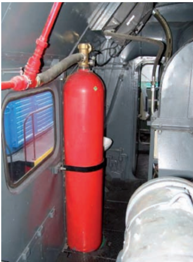
Rys. 24. Zabudowa butli z gazem F200 stałej instalacji gaszącej
