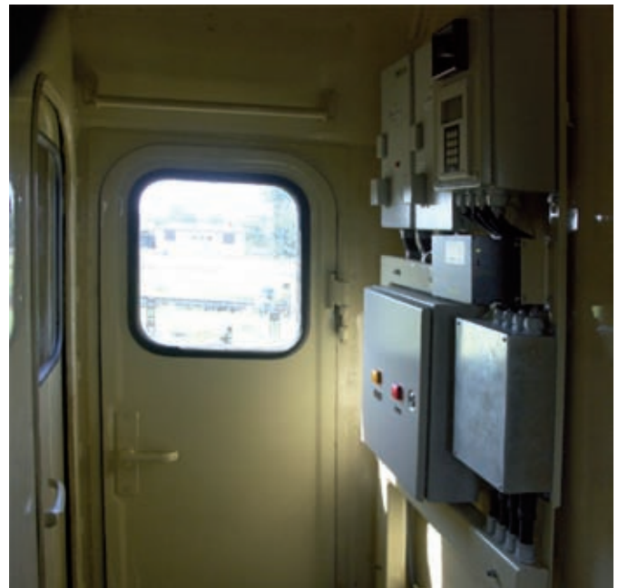
Rys. 7. Widok na ścianę boczną przedsonda lokomotywy BR232 z zabudowanymi generatorami CA, SHP, jednostką centralną prędkościomierza, zespołem hamowania nagłego 20ZH i szafką sterującą
