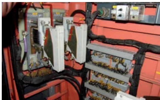
Rys. 22. Zabudowane styczniki elektropneumatyczne – liniowe SPG-1600 (na górze) i do rozruchu silnika spalinowego STT-302-3 (na dole)
