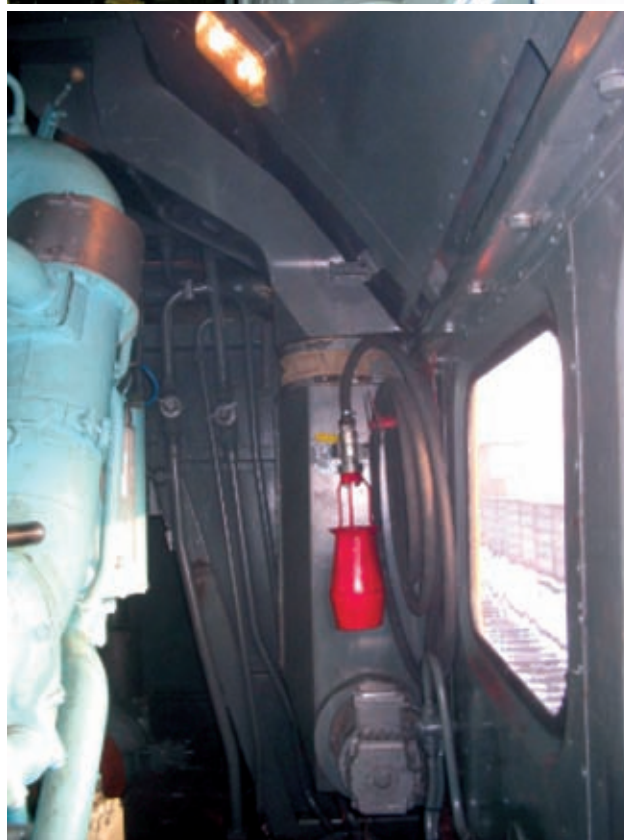
Rys. 15. Stała instalacja gasząca, zabudowana w doposażonej lokomotywie M62 – rozmieszczenie zbiorników i orurowania (górze) oraz prądnic z węzłem (dół)
