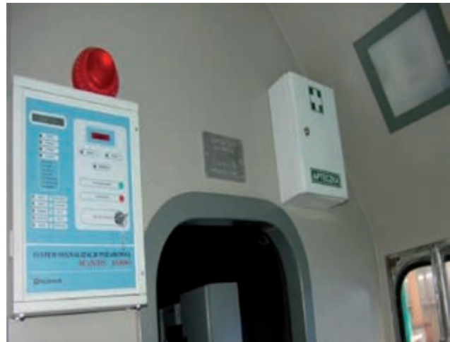
Rys. 25. Centralka i sygnalizator optyczno-akustyczny w kabinie sterowniczej
