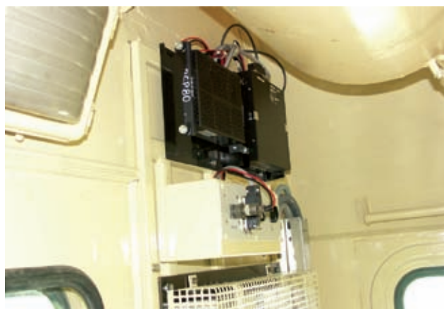
Rys. 14. Układ nadawczo-odbiorczy radia, zasilacz radia i zasilacz urządzeń bezpieczeństwa ruchu zabudowane na ścianie tylnej przedsiionka lokomotywy BR232
