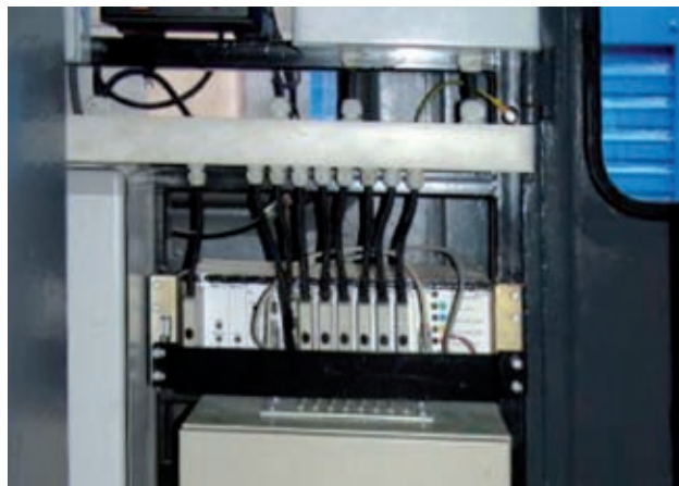
Rys. 34. Jednostka centralna (komputer pomiarowy i rejestrujący) typu LTZ Metra Blansko
