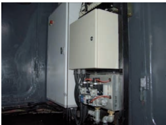
Rys. 32. Zespół hamowania nagłego 20ZH, szafa z przekaźnikami i przetwornicą 75/24V DC oraz moduł główny firmy Metromix
