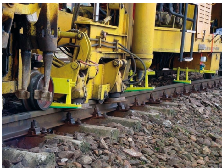
Rys. 10. Ogólny widok zestawu przyrządów do pomiaru przemieszczeń zainstalowanych na podbijarce torowej
