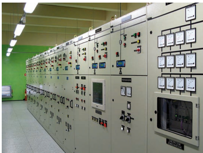
Rozdzielnica 660 V z automatyką CZAT 3000plus
