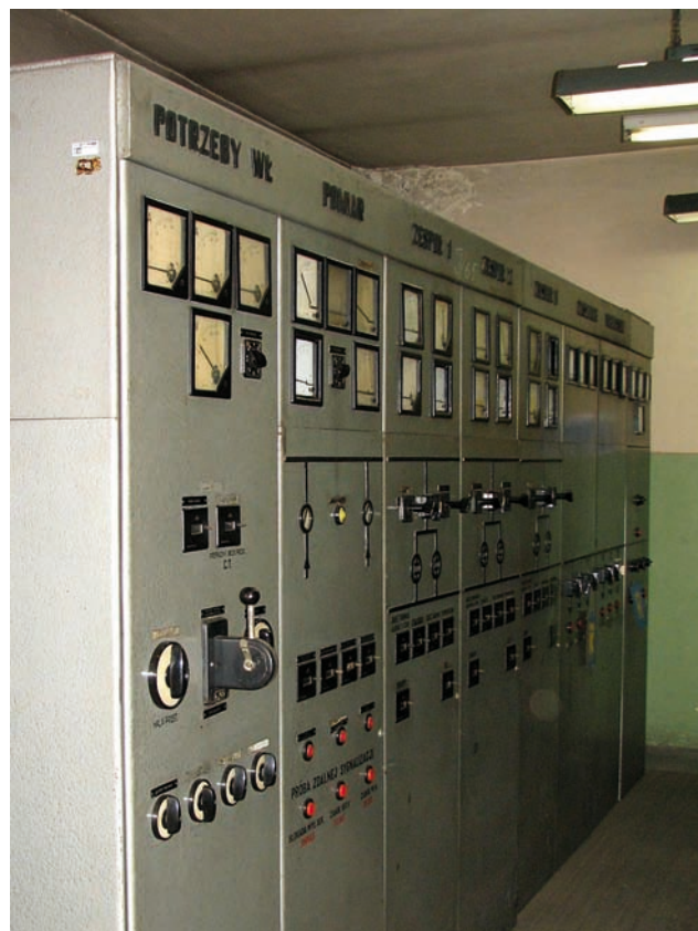
Tablica sterownicza w pomieszczeniu nastawni
