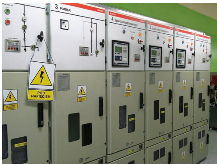
Rozdzielnica 15 kV z zabezpieczeniami megaMUZ
