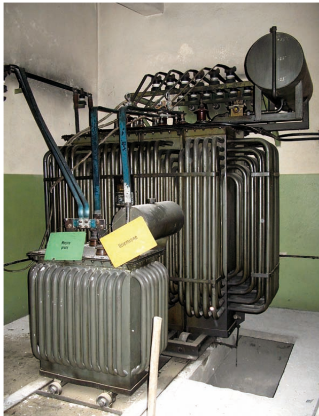
Transformator prostownikowy i dławik wyrównawczy
