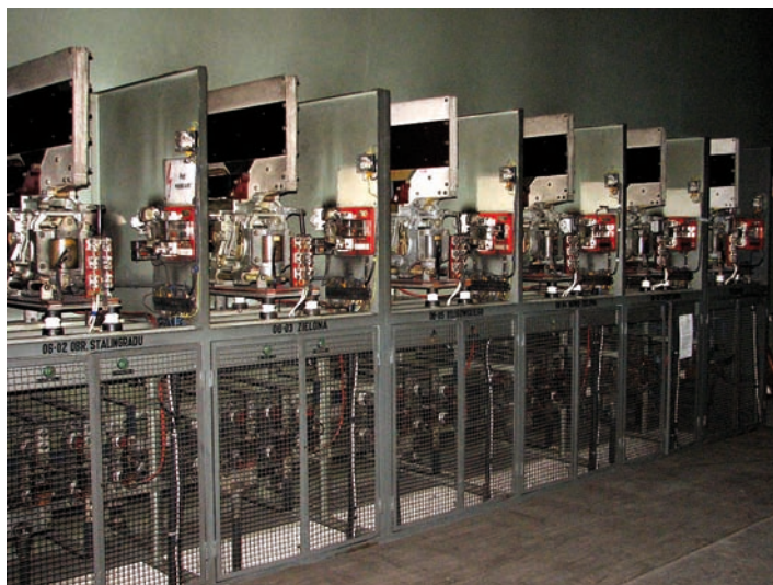
Rozdzielnica 600 V z wyłącznikami szybkimi WSe
