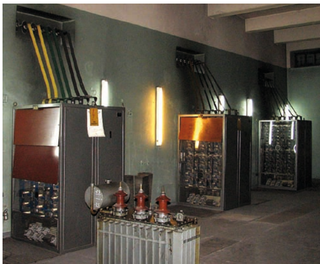
Wyeksploatowane prostowniki PK-09/0,66
