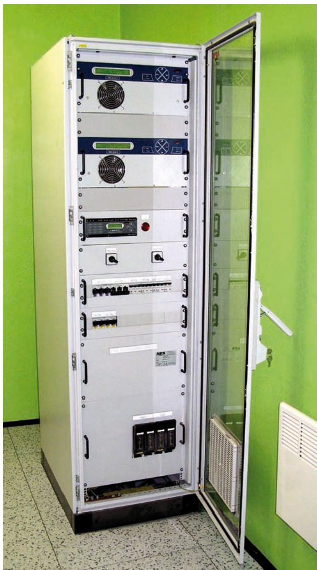
Siłownia prądu stałego 220 V
