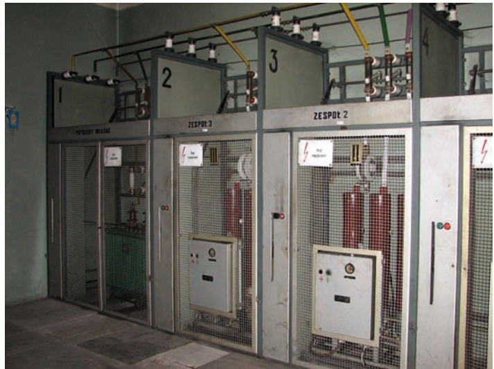
Rozdzielnica 6 kV z wyłącznikami WMRWS
