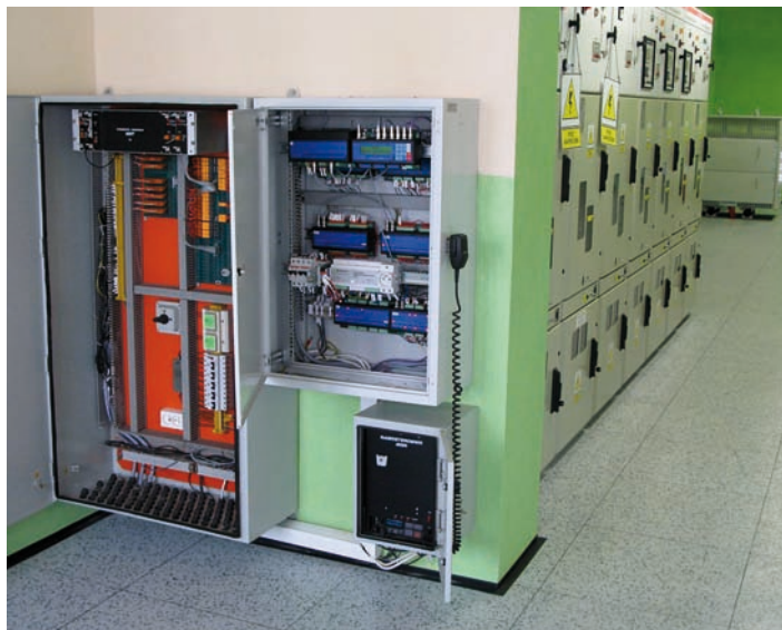
Szafa obiektowa telemechaniki i urządzenia łączności
