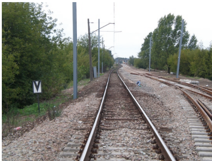
Fot. 1. W sierpniu 2008 r. minął rok od rozpoczęcia modernizacji odcinka Warszawa – Nasielsk; pociągi nadal przejeżdżają z prędkością 20 km/h po znajdującym się w bardzo złym stanie torze nr 2 między posterunkami odgałęźnymi Miłchatów i Targówek
