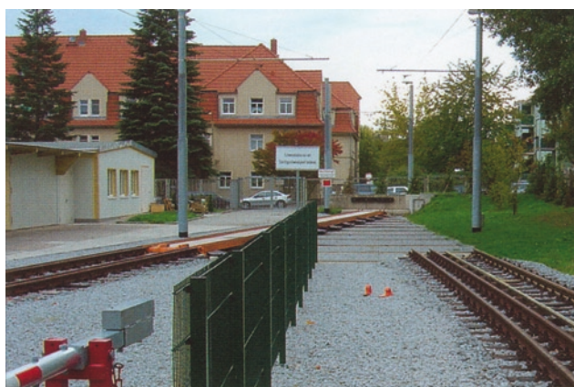
Rys. 40. Budziszyn – trzyszynowa zwrotnica o ruchomych opornicach łącząca halę uruchomienia z długim torem do prób
