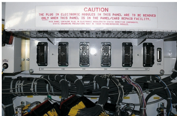
Fot. 7. Szafa elektryczna i panele elektroniczne
