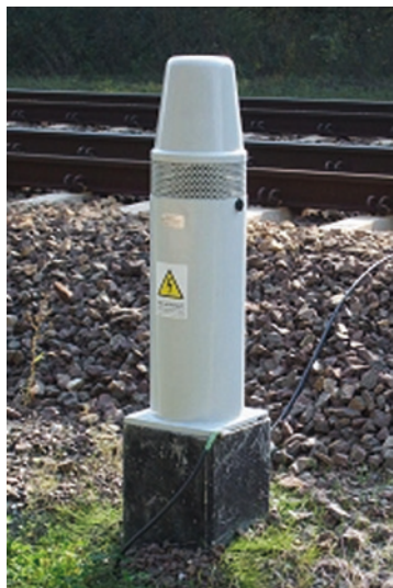
Urządzenie UOZ-1 zainstalowane przy torze kolejowym
