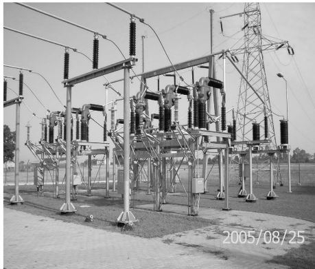
Rys. 4. Rozdzielnia 110 kV i linia zasilająca podstację z zespołami typu PD17
