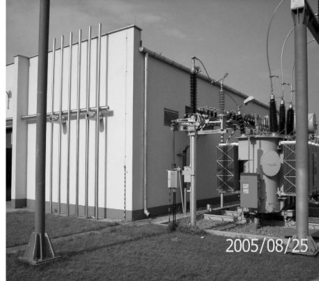
Rys. 3. Budynek podstacji trakcyjnej i transformator do zespołu typu PD17
