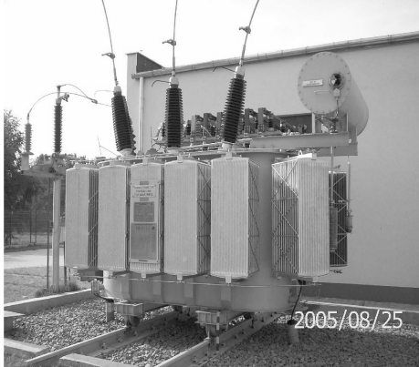
Rys. 2. Transformator o mocy 7,4 MVA do zespołu typu PD17
