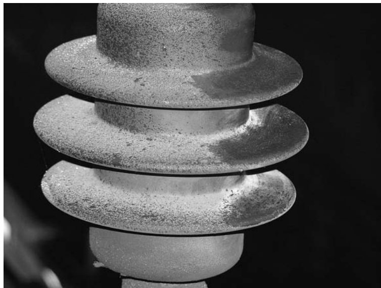
Rys. 12. Zanieczyszczony izolator LTG z żywicy epoksydowej w hali dworca Wrocław Główny
