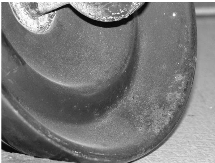
Rys. 13. Szklivo izolatora kołpakowego z zanieczyszczeniem metalicznym pokrytym rdzą
