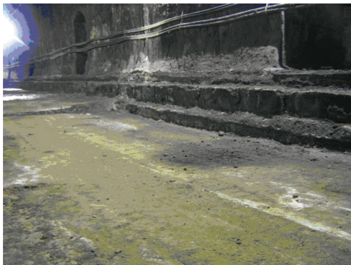
Fot. 4. Nierówności odkrytej płyty dolnej w powiązaniu ze ścianą tunelu
