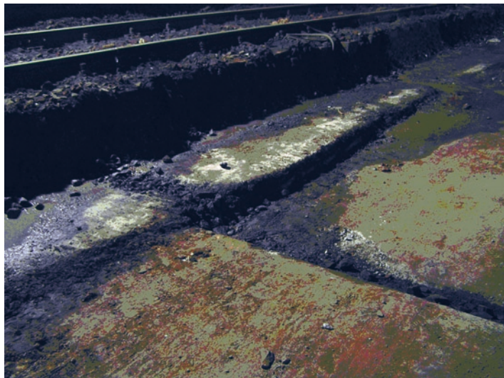
Fot. 3. Nierówności odkrytej płyty spągowej (dolnej) wraz ze szczelinami dylatacyjnymi
