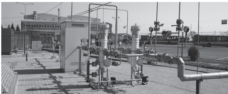
Rys. 2. Instalacja gazowa w MPK Rzeszów. Fig. 2. Gas installation in MPK Rzeszów.
