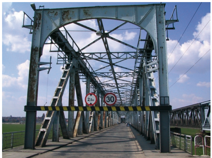
Most drogowy od wielu lat nie jest remontowany, obecnie przez most mogą przejeżdżać jedynie pojazdy do 3,5 t, o wysokości nie większej niż 2,5 m; prędkość na moście ograniczona jest do 30 km/h
