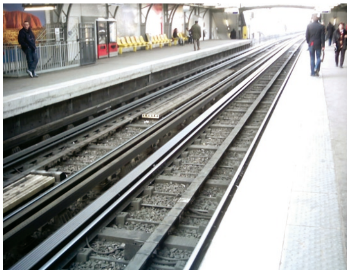
Rys. 6. Szyny prądowe i jezdne w metrze w Paryżu
