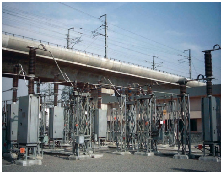
Rys. 16. Jedna z dwu podstacji elektroenergetycznych 220/25 kV do zasilania trzech linii metra w New Delhi o łącznej długości 63 km (jedna z dwóch linii na estakadzie, trzecia linia w tunelu)
