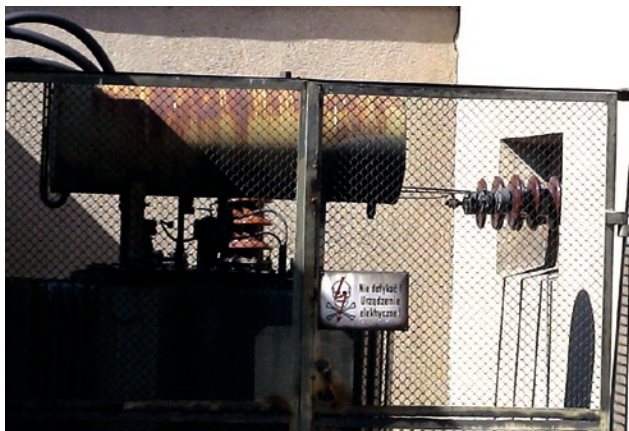
Rys. 21. Wyeksploatowany transformator w jednej z podstacji tramwajowych
