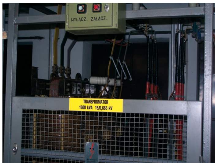
Rys. 15. Transformator suchy w Metrze Warszawskim
