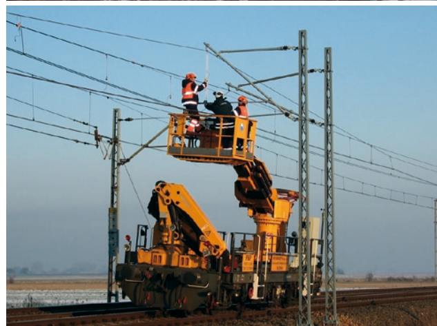
Rys. 10. Kolejny etap montażu sieci jezdnej, wieszakowanie, czyli mocowanie przewodów jezdnych do liny nośnej, a następnie wykonanie uelastyczniania sieci, wykonanie połączeń elektrycznych i ostateczna regulacja
