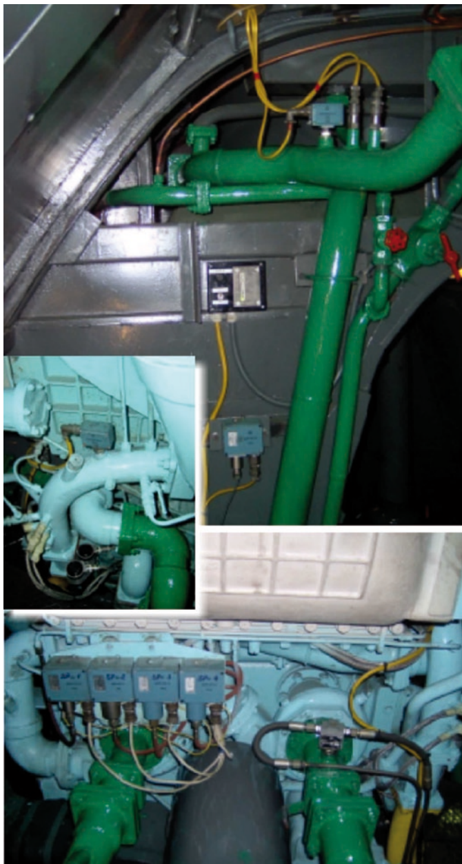
Rys. 9. Widok na zespoły i urządzenia układu automatycznej regulacji temperatury SART
