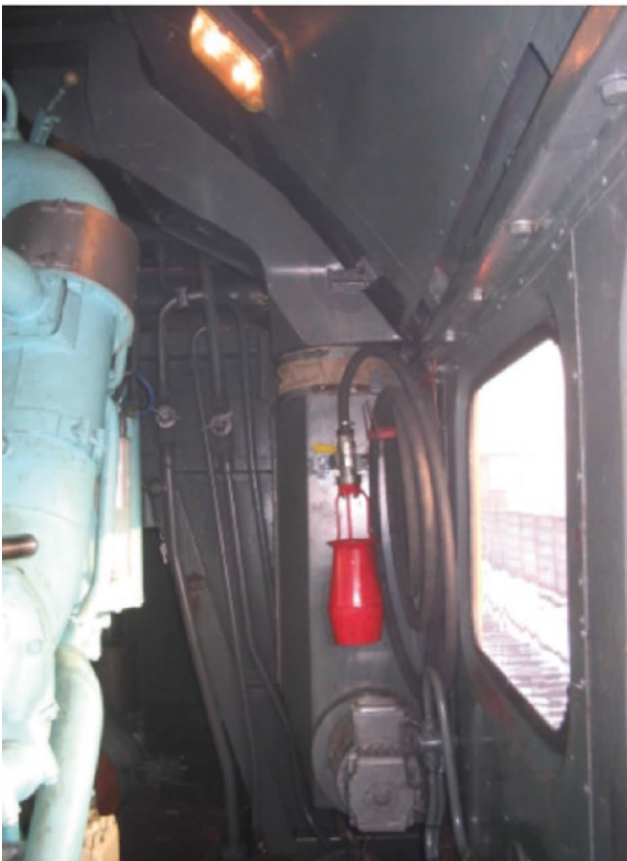
Rys. 6. Zabudowa kanału wlotowego do filtra powietrza a - widok z zewnątrz lokomotywy, b - widok od wnętrza lokomotywy
