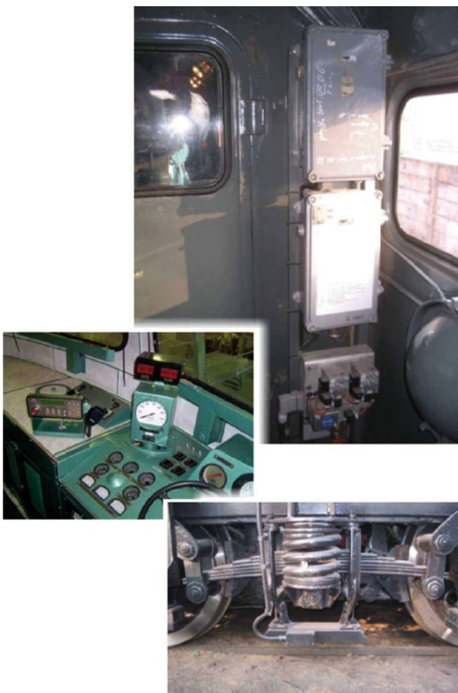
Rys. 16. Zabudowa urządzenia układu bezpieczeństwa ruchu a - zabudowa generatora SHP i CA oraz zespołu hamowania nagłego 20ZH, b - zabudowa lampek sygnalizacyjnych nad pulpitem sterowniczym, c - zabudowa elektromagnesu ELM 2003
