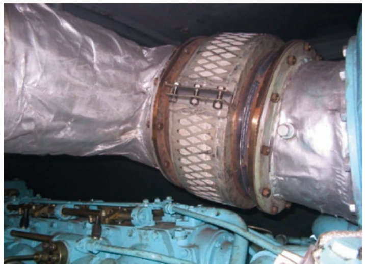
Rys. 8. Zabudowa kolektora wylotowego a - widok na połączenie tłumika, wylotu spalin i kolektora, b - widok w zbliżeniu na kolektor
