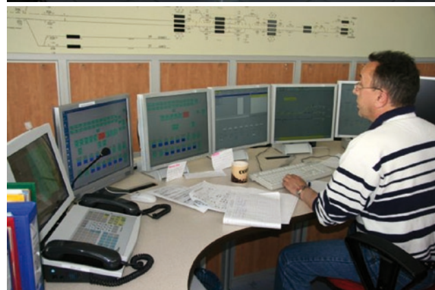
Fot. 7. Centrum sterowania systemem zasilania trakcyjnego
