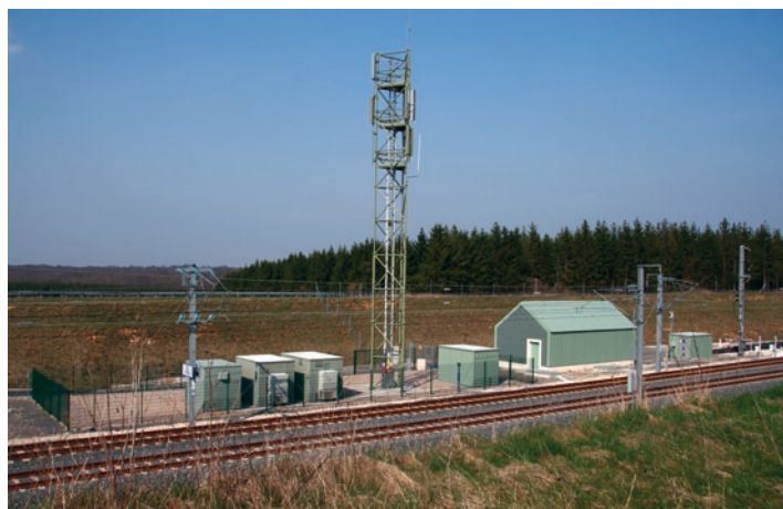
Fot. 4. Stacja bazowa systemu łączności radiowej GSM-R
