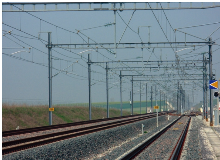
Fot. 1. Stacja techniczna Tilloy et Bellay w km 166 linii wschodnioeuropejskiej TGV; widoczny tor główny dodatkowy zakończony żeberkiem ochronnym (rozjazd łukowy) i dwa tory główne zasadnicze
