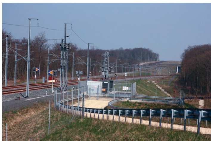
Fot. 5. Autotransformator trakcyjny
