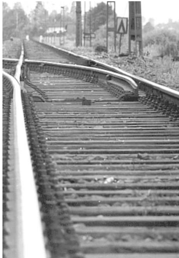
Rys. 14. Przesunięcie rozjazdu w kierunku międzytorza i krótka nierówność pozioma w lewej szynie łączącej
