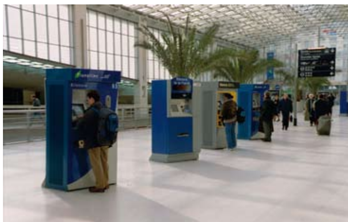
Automaty biletowe na dworcu Gare de Lyon dla systemu kolei aglomeracyjnej Transilien należącej do SNCF (region paryski)
