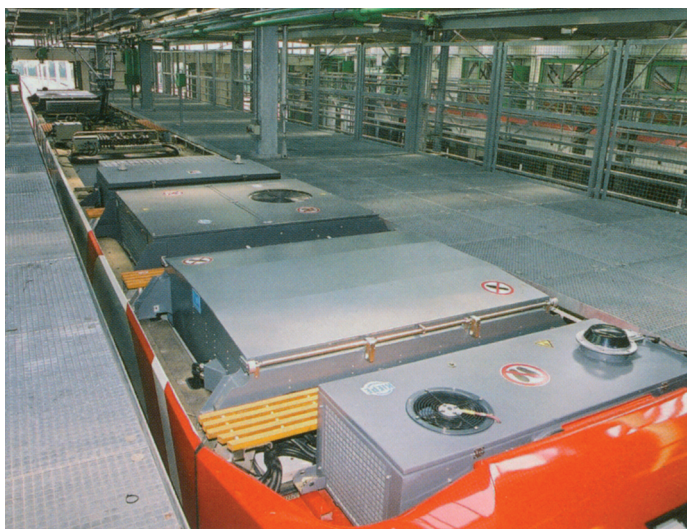
Rys. 31. Wagon K4500, dach: urządzenie klimatyczne kabiny motorniczego, przekaźnik prądowy, urządzenie klimatyczne, BNU, opornik hamowania
