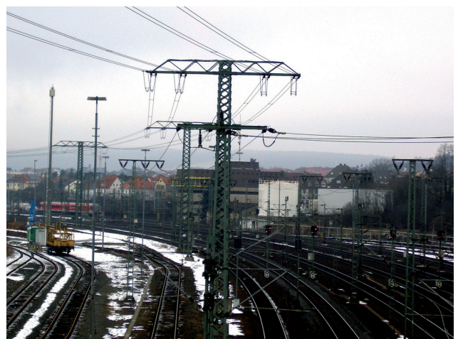
Fot. 4. Energetyczna sieć kolejowa 2×110 kV 16,7 Hz
