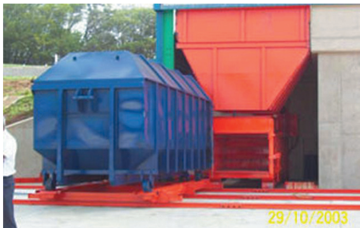
Fot. 14. Przejzdna platforma szynowa w przesypowni odpadów komunalnych w Umhlanga (RPA) [18]
