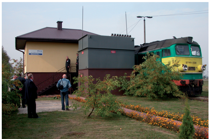
Najnowocześniejsza w Polsce stacja diagnostyczna zespołów napędowych lokomotyw spalinowych Fot. A. Bąk
