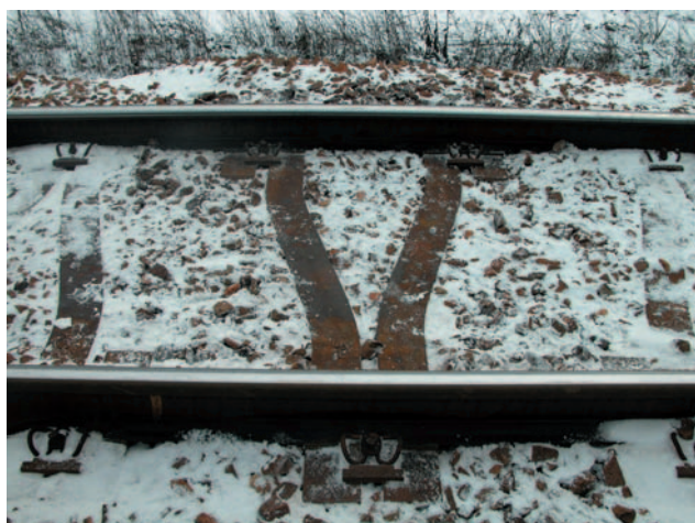
Fot. 3. Widok wybranego podkładu stalowego typu Y po 12 miesiącach eksploatacji
