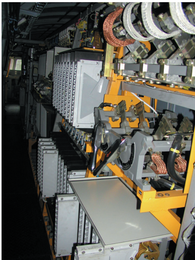
Zmodernizowana szafa WN1 zamontowana w lokomotywie
