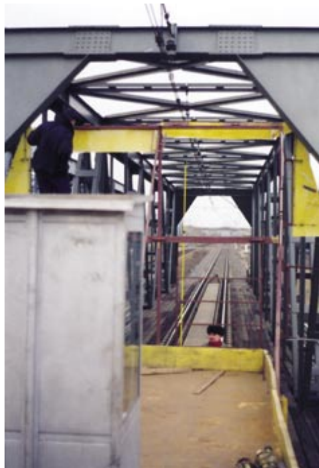
Rys. 4. Kolizja skrajnika z blachownicami mostu na kanale Grójeckim Źr. Andrzej Etmanowicz
